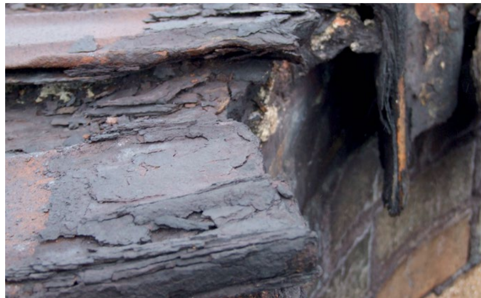
Foto 9.5: Zkorodované železné obložení komína vysloužilé spalovny odpadů.
