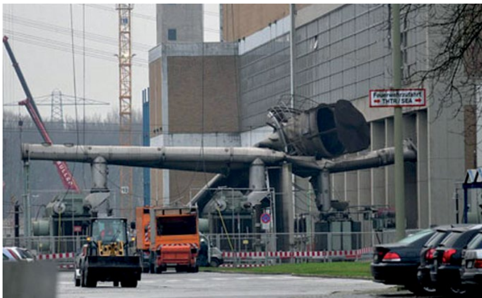
Foto 7.5 Komín pyrolýzy v Hammu zkorodoval a v roce 2009 se poroučel k zemi. Už nikdy nebyl obnoven. Foto: Reiner Mors, tz.de, zdroj (dpa, 2009).
