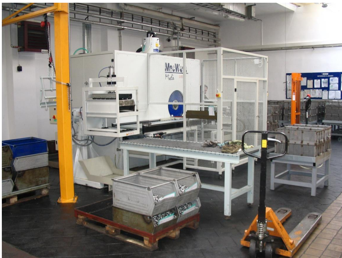
Obr. 5: Nové odmašťovací zařízení Midi 400 v provozu Brisk Tábor. Díky jeho instalaci mohl výrobce zapalovacích svíček nahradit ve výrobě do té doby používaný tetrachlorethylen. Zařízení bylo instalováno v rámci environmentálního projektu „Odmašťování kovových dílců“ podpořeného Státním fondem životního prostředí. Foto: Brisk Tábor, a.s.
