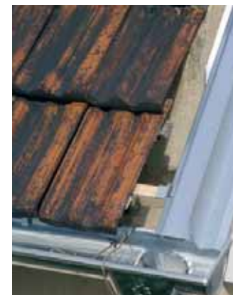
Do nákladů na zateplení je nutno započítat i nové římsy, parapety a další stavební úpravy. Foto: EkoWATT
