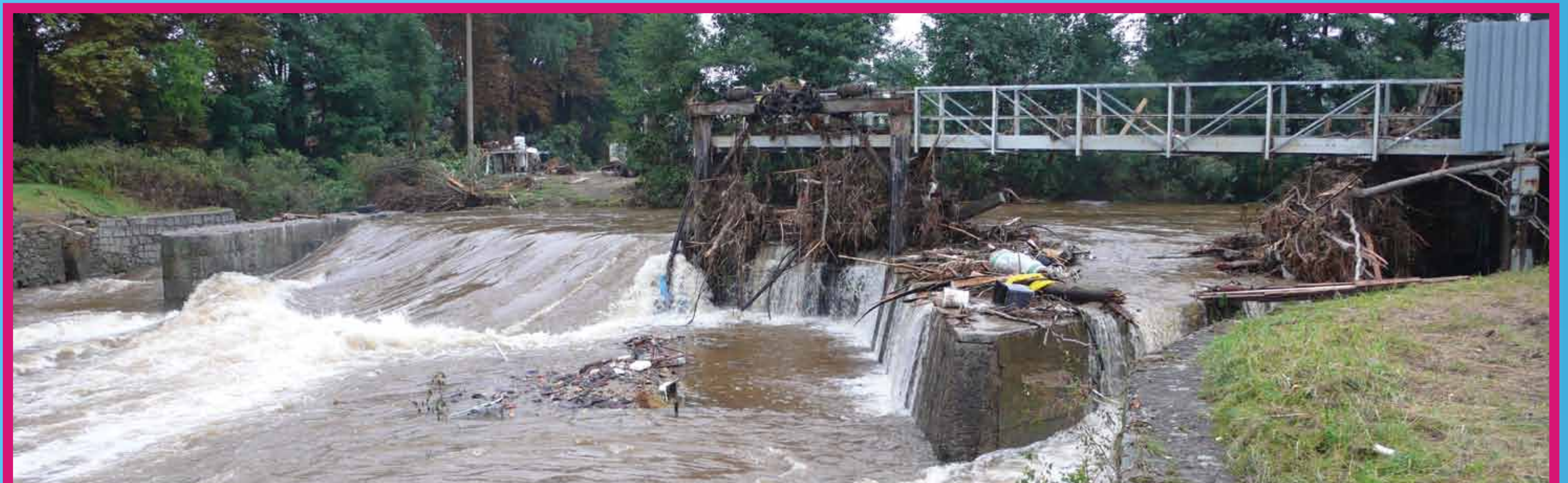
Jez ve Frýdlantu po povodni 2010 již po odstranění větší části zachyceného splávi. Jez při povodních zvedá vodní hladinu a zhoršuje jejich průběh.
